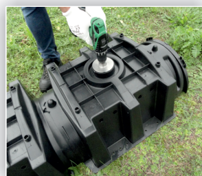
8. W ostatnim tunelu każdej nitki należy wyciąć zaślepiony otwór przy użyciu otwornicy.
